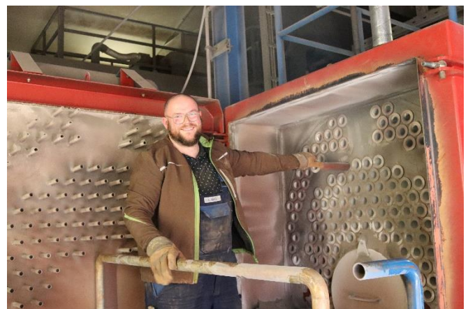
Als Heizmeister betreut Axel Hartje bereits seit acht Jahren das Heizwerk in Glonn. (Foto: MW Biomasse AG)
